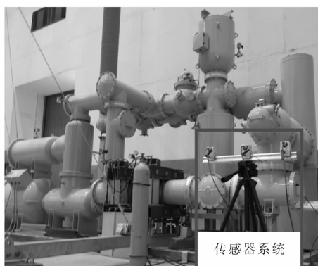
图8 330 kV GIS 现场试验示意图
