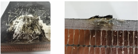
(a)正面 (b)切面 图 11 定子线棒研磨表面局部
