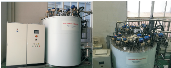
图 3 低温测试平台 ADS 500 W/4.5 K 以及冷箱盖板实物 Fig. 3 Cryogenic test platform ADS 500 W/4.5 K and cold box cover plate physical picture
