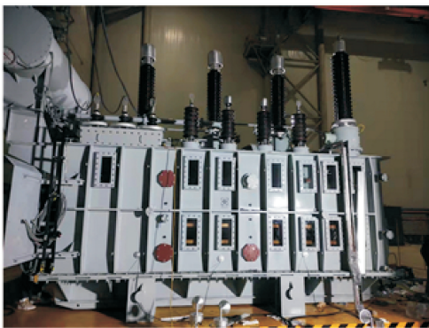
图 5 110 kV 真型变压器非电参量特性实验平台 [71]
