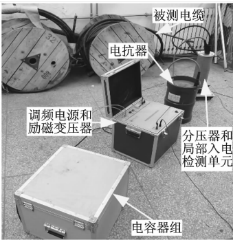
图 13 电缆负载测试实物图
